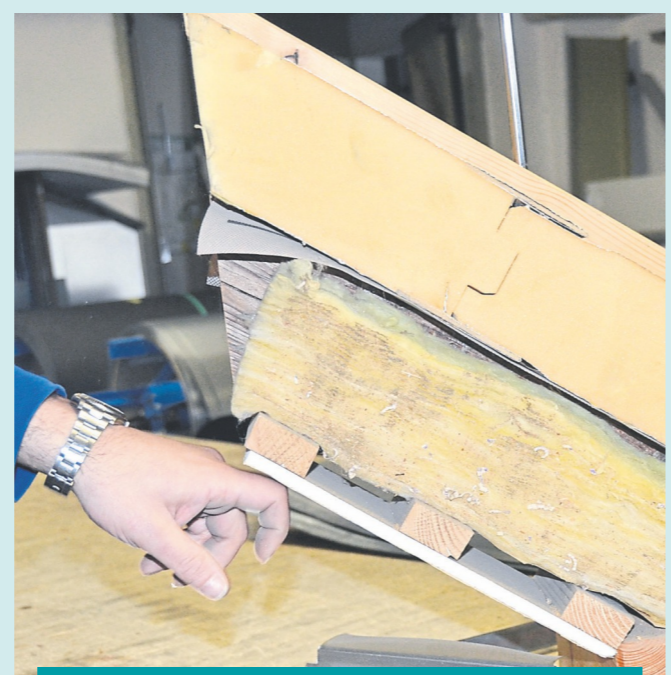
Zwischen den Sparren sieht man die alte Dämmung mit Wärmebrücke. Auf den Sparren liegt die neue Dämmung. Sie ist wärmebrückenfrei durch spezielle Kanten die ineinander greifen.
